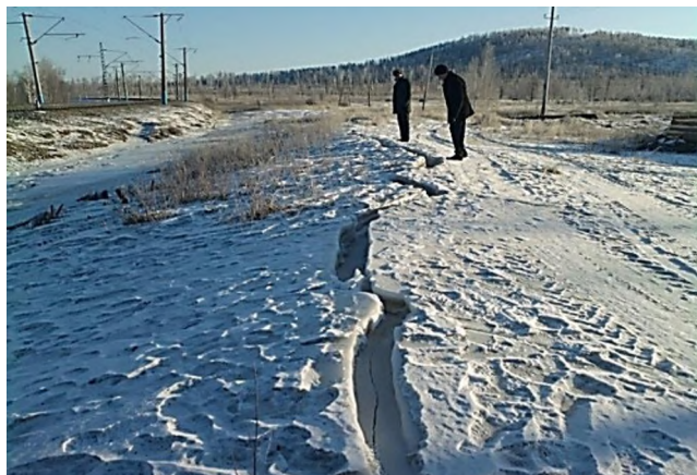
Рисунок 2 – Бугор наледи у моста и вдоль насыпи дороги
